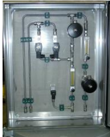
Chlordosierung Chlorine dosing
